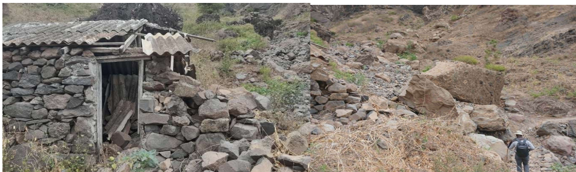
Fotos 8: casa de animais destruídas pelas chuvas e rochedos movidos pelas enchurradas. Fonte: consultoria.
